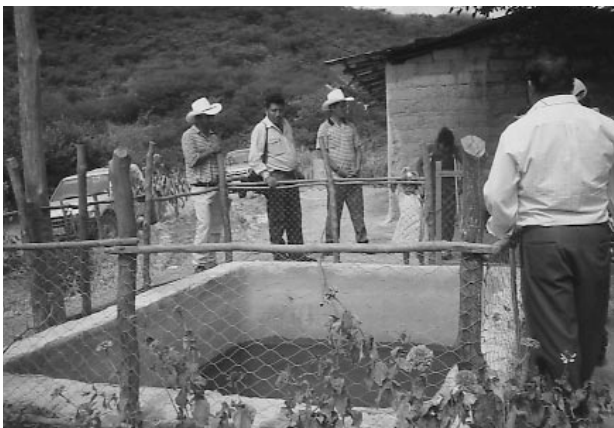
Pozo construido cerca de la casa, para usos domésticos, Sabana Grande, F.M., Honduras.
