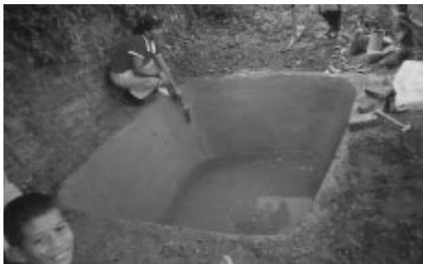
Pozo repellado con mezacala de arena, cemento y tela de alambre, Sabana Grande, F.M., Honduras.
