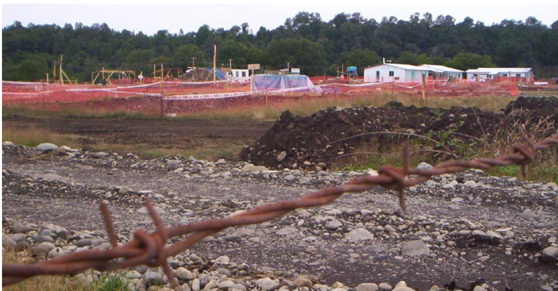
Planta de tratamiento de aguas servidas en Putue.
