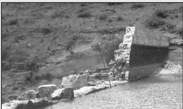
Figura 21. Afectaciones a la infraestructura de riego
