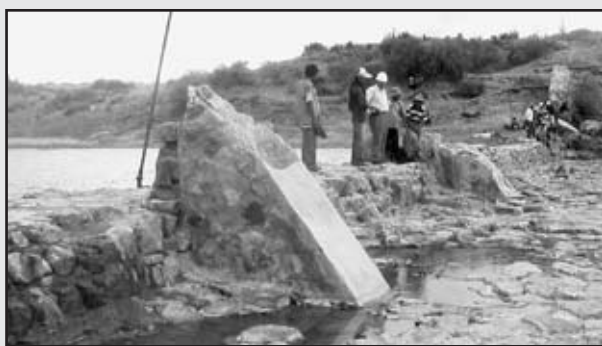
Figura 22. Muro de la presa afectada.
